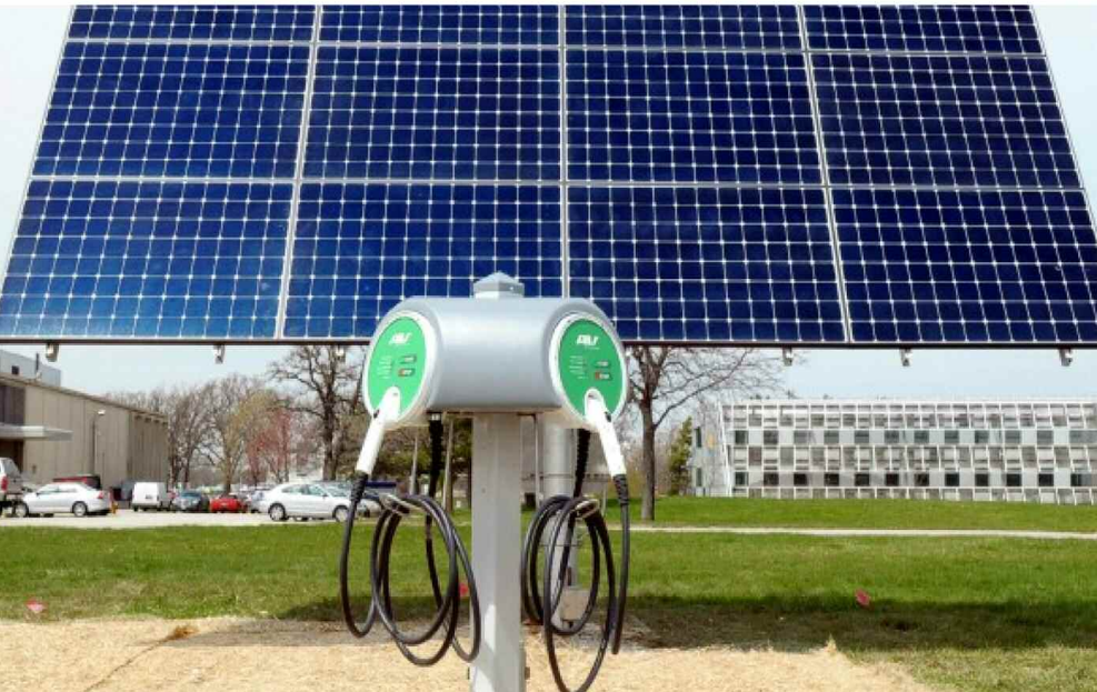
Σταθμός φόρτισης ηλεκτρικού οχήματος όπου η ηλεκτρική ενέργεια παράγεται με φωτοβολταϊκά πλαίσια.
