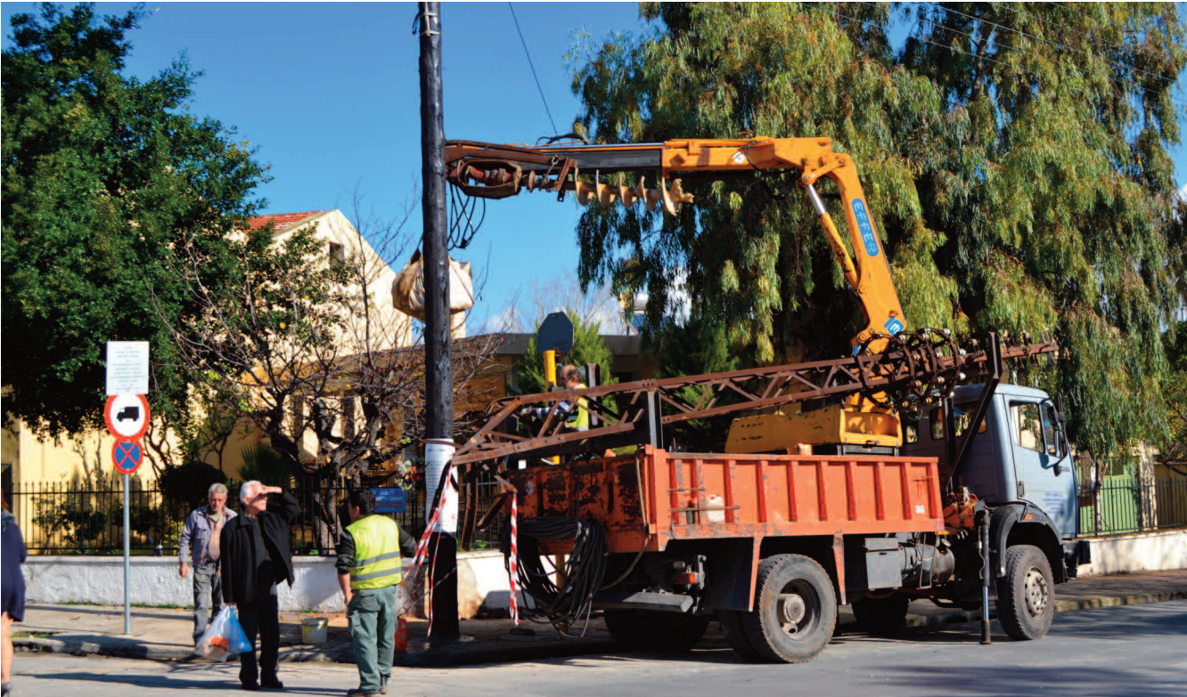
Η αφαίρεση της παλαιάς μεταλλικής κολόνας, που χρονολογείται από την εποχή του Ελευθερίου Βενιζέλου, κρίθηκε αναγκαία σύμφωνα με τους αρμόδιους, καθώς μετά από το τροχαίο ατύχημα που σημειώθηκε πριν από λίγες ημέρες “κόπηκε” η βάση της.
